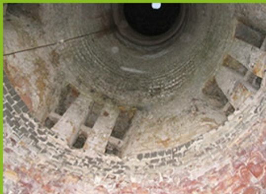
Vista interna del forno
