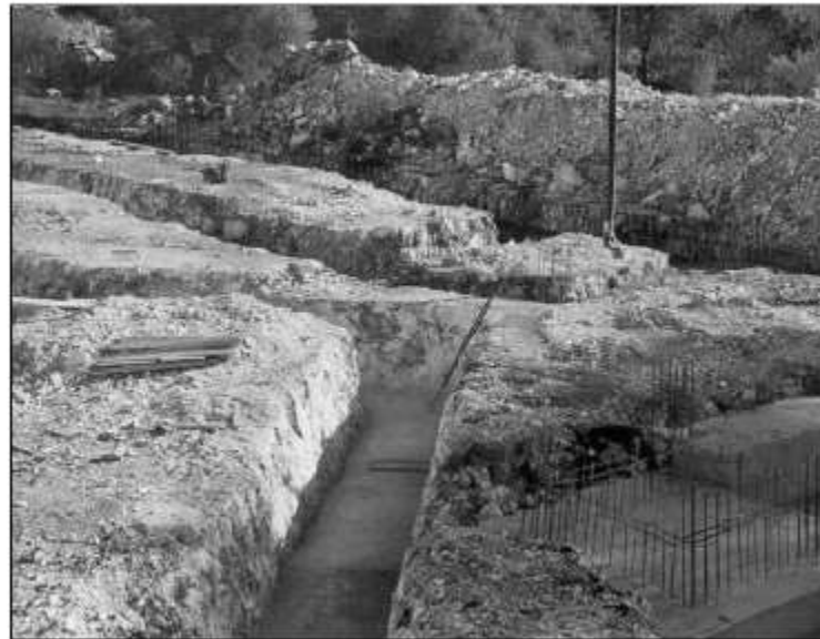
Scavo a sezione ristretta per la realizzazione di travi rovesce di fondazione
