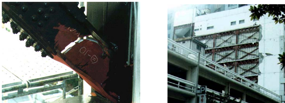
Figura 1: Effetti del terremoto di Kobe (1995) sulle strutture in acciaio. A seguito di tale evento la Japanese Society of Steel Construction ha emanato le linee guida JSSC 1997.
