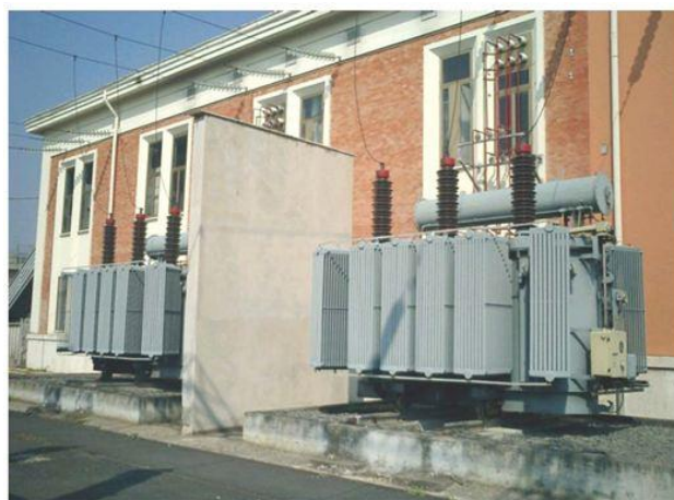
Fig.4.10- Trasformatori di gruppo AT/MT.
