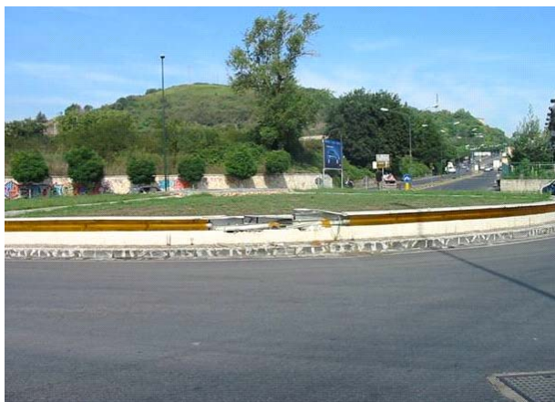
Figura 7 Cordolo dell'isola centrale pericoloso nella rotatoria 11 (Via Cinthia).
