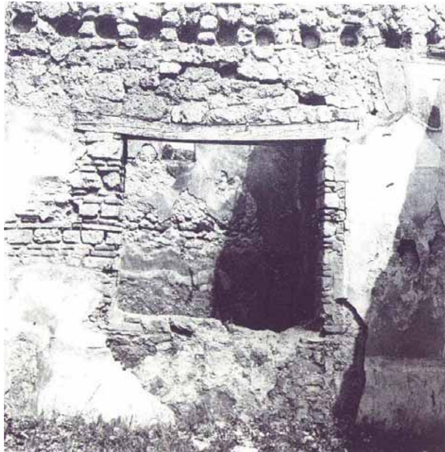
Rottura ad arco naturale al di sopra di un architrave
